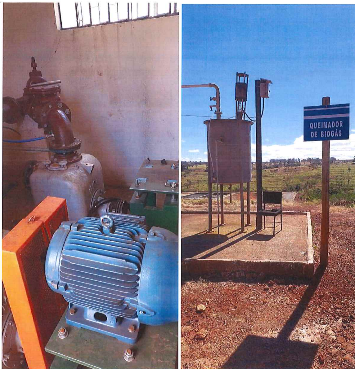
Figura 13. Detalhe da motobomba reserva inoperante na EEE-3 Rosário e do Queimador de gás na ETE.
