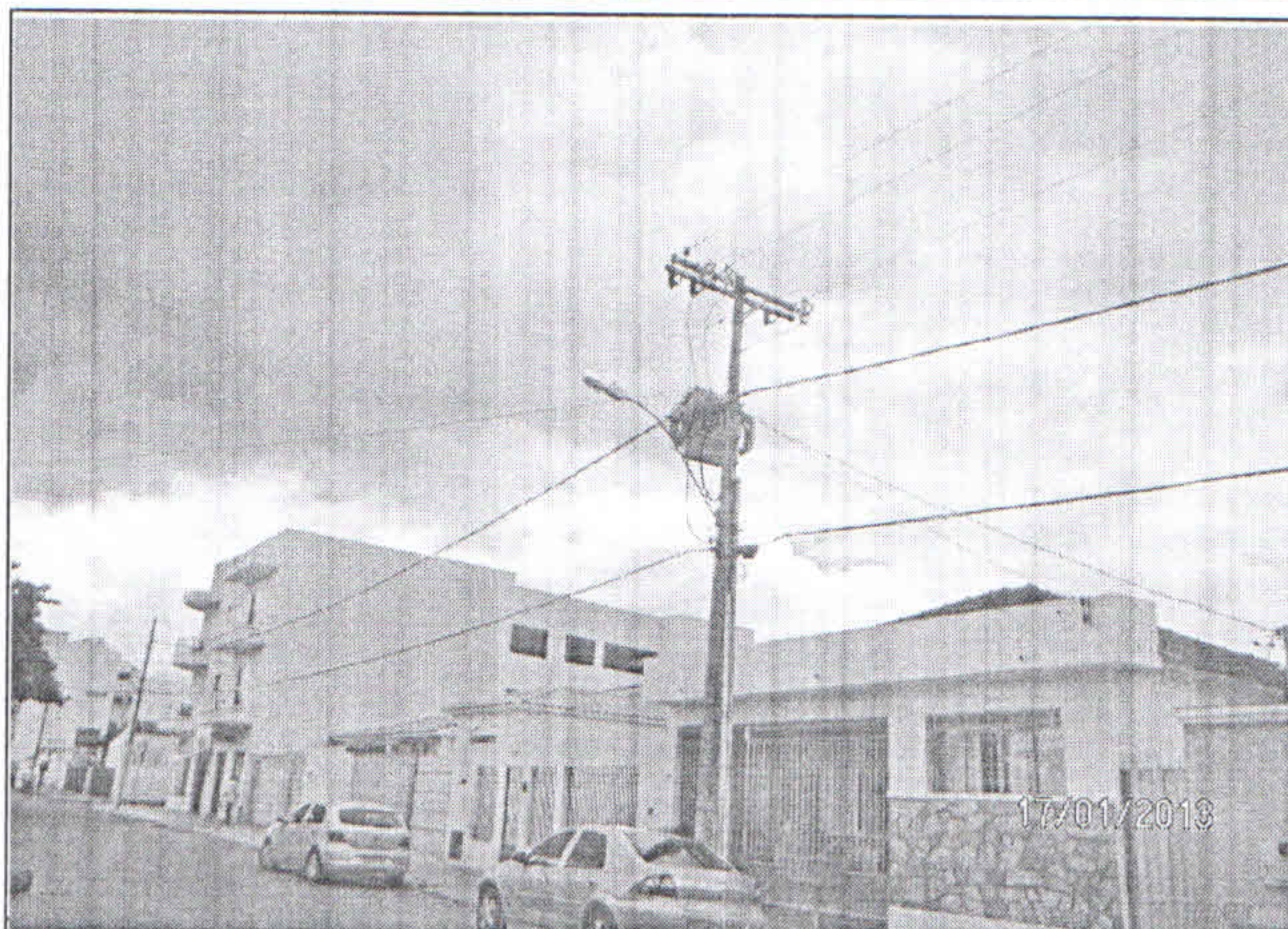
FOTO 09 VISTA DO TRANSFORMADOR
